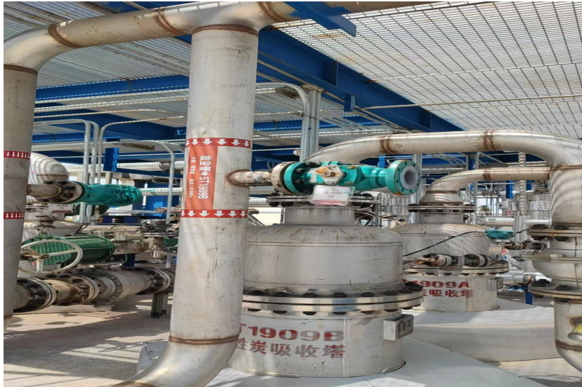
图 4-3 活性炭吸收处理设施
