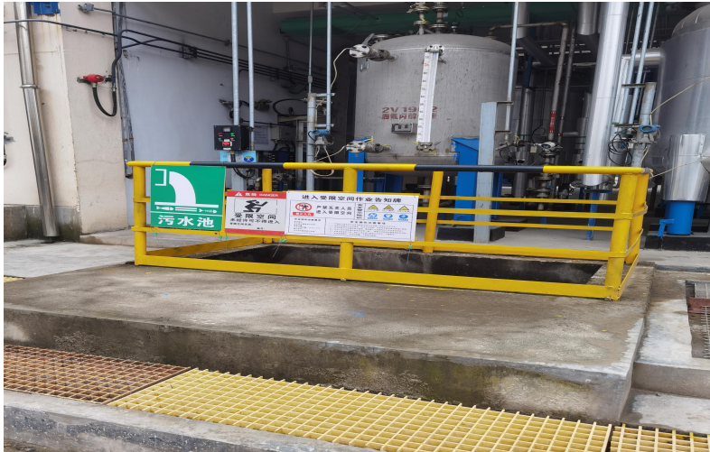
图 4-1 项目生产废水收集池
