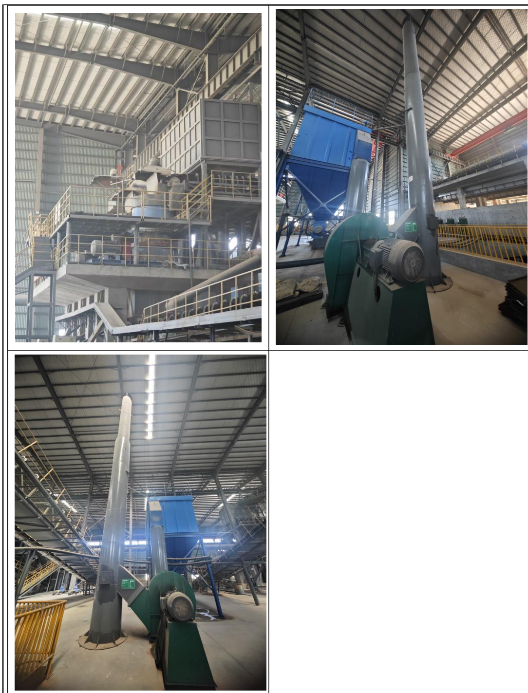
图 3-4 项目废气处理设施及排放口
