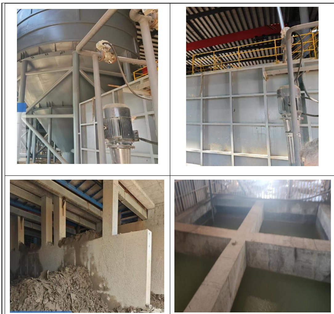
图 3-2 项目废水处理设施
