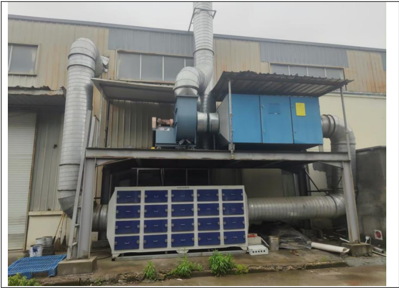
图 3-2 项目废气处理设施及排放口
